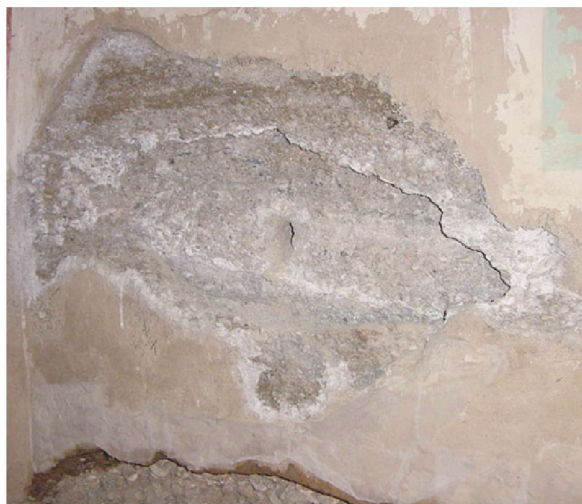
写真2: 壁画の損傷を助長する塩害状況
